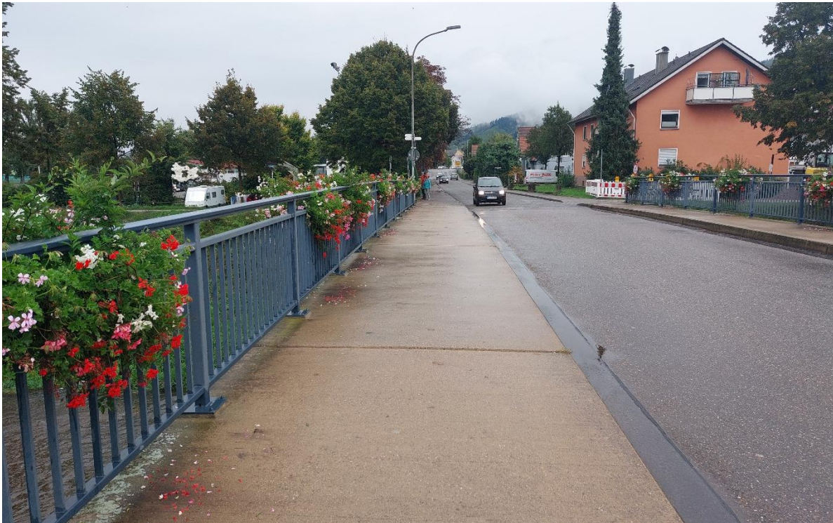
Abbildung 45: tiefe Fugen an der Renchallee
