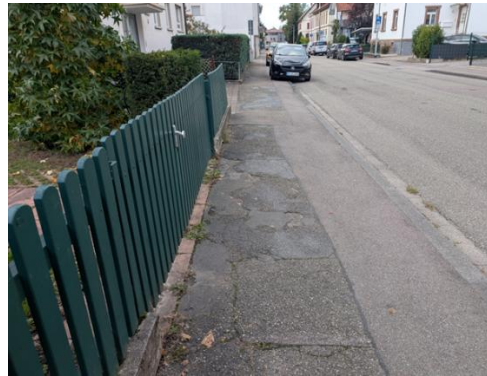
Abbildung 24: Schäden in der Belagsoberfläche
