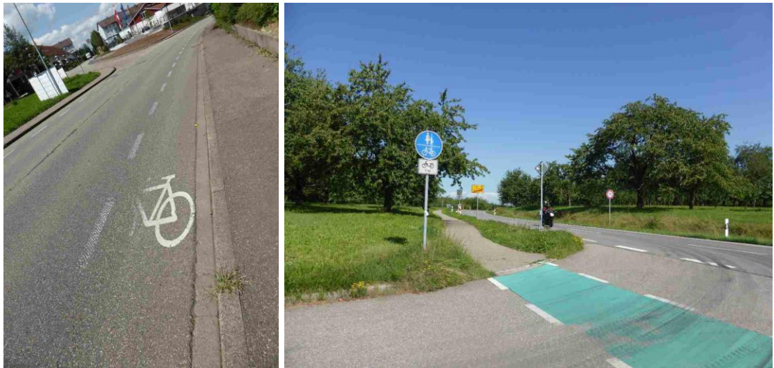
Abbildung 6: Beschädigte Markierung auf der Renchener Straße westlich des Kreisels Ringelbacher Straße (links) und am Knotenpunkt Landstraße / Heugasse
